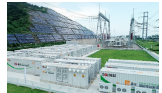
海丰 AGC 储能调频项目
